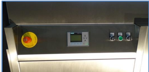
Blick auf die SPS- Steuereinheit
